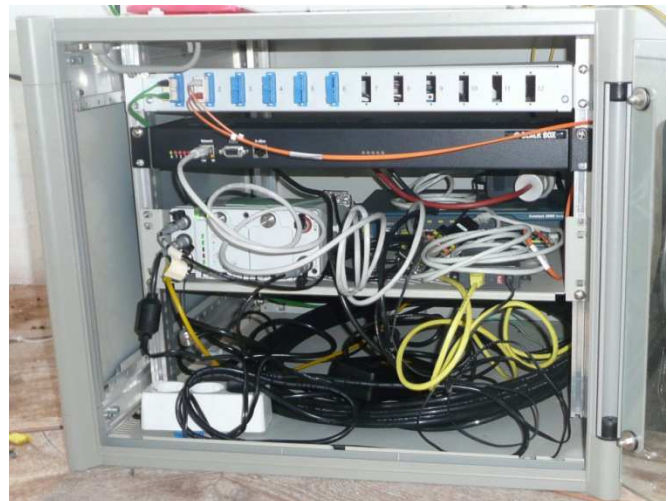
Abbildung 3: Hardware-Rack der RTK-Monitorstation Freising (RTK-Empfänger Leica GS10, Remote-Power-Switch, Kommunikationshardware)
